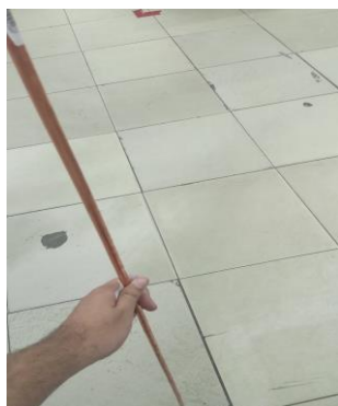
Figura 10: Haste de aterramento.
