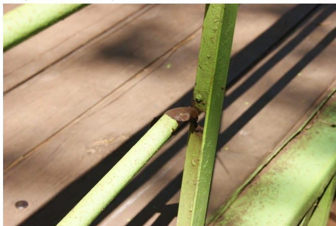
Figura 3 – Desgaste da estrutura metálica
