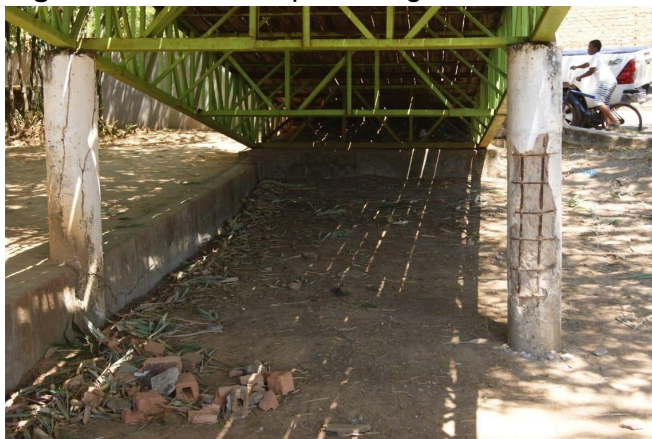
Figura 2 – Pilares de ponte degradados
