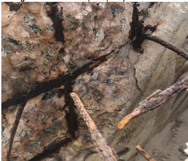
Figura 2 – Estrutura após aplicação de fenolftaleína
